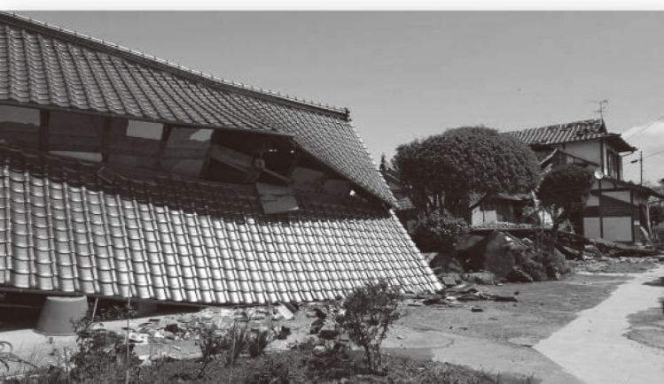
写真 1階部分が押しつぶされた建物（出典：キロクマ！熊本素材写真アーカイブス）
