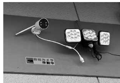
藤井下組集会所に設置された 防犯カメラ
