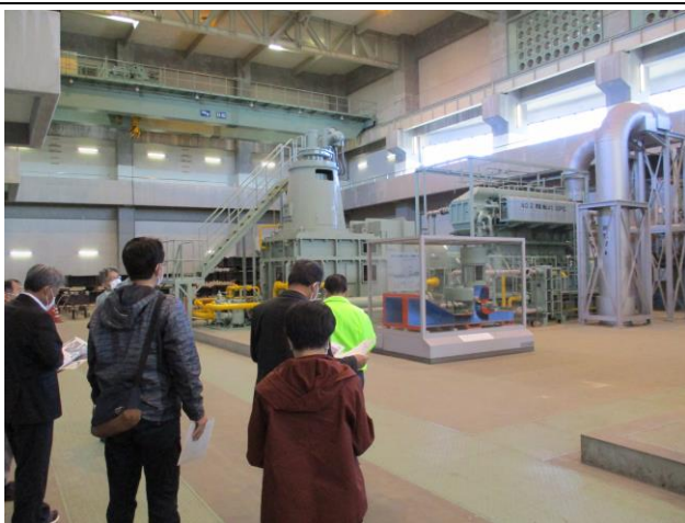
中川上流排水機場内施設（排水ポンプ）
