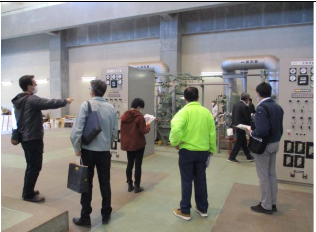
中川上流排水機場内施設（電源装置）
